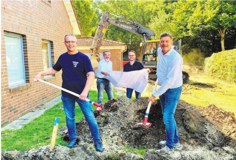
Das Feuerwehrhaus wird zur Baustelle: Ortsbrandmeister Stefan Buschmann, Bürgermeister Christoph Reents (vorn, v. l.) beim ersten Spatenstich; (hinten) Architekt Michael Pohl und Amtsleiter Sven Wiedenfeld.
